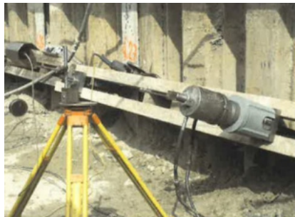
Gesamtsystem mit Presse und Wegmessung
