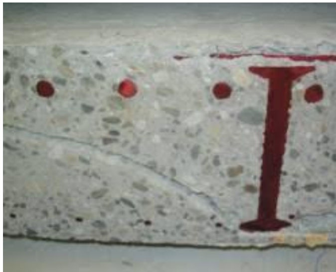
Rissbild Decke mit Durchstanzdübel verstärkt
